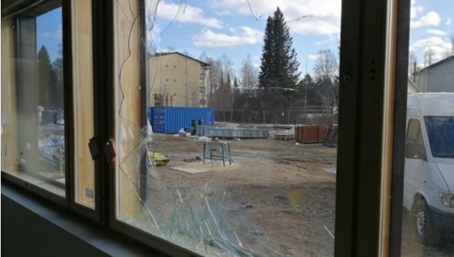
A120 luokkaan ikkuna rikottu lauantain / sunnuntain välisenä yönä
