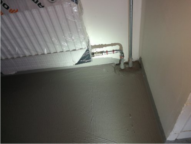
A 324 vessan lattia vedeneristetty, patteriputkien läpimienon kohdalla syvä monttu joka täytyy täyttää ennen laatoitustyön aloitusta.
