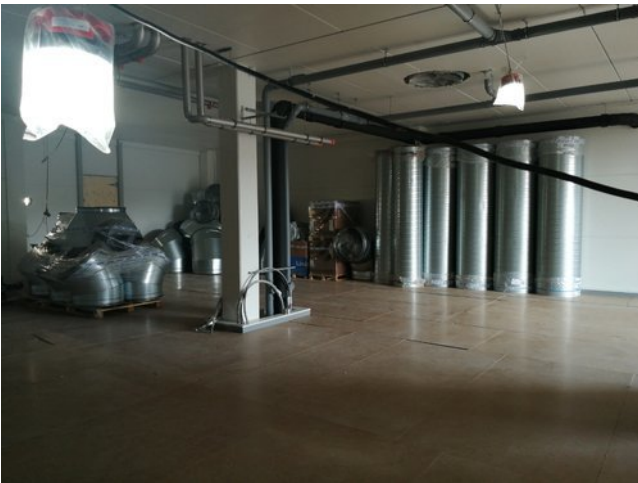
Osia IV-konehuoneessa A335
