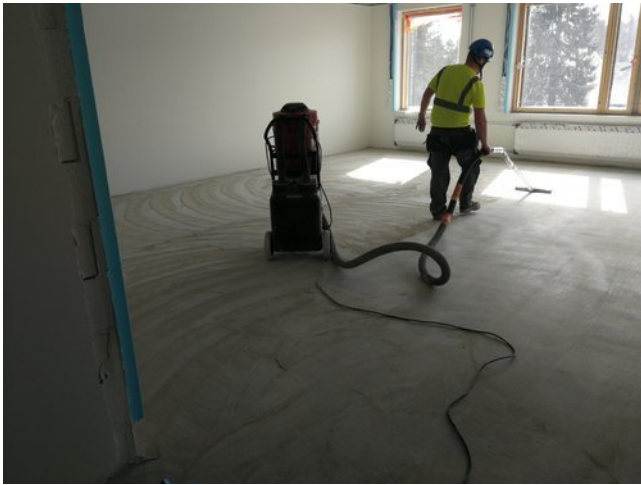
A205 huoneen lattiahiottu. Betonipölyä jonkin verran noussut alakaton valaisimien päälle
