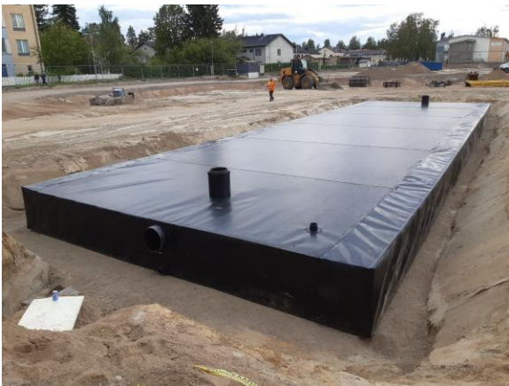
Huleveden viivytyskasetti asennettu.
