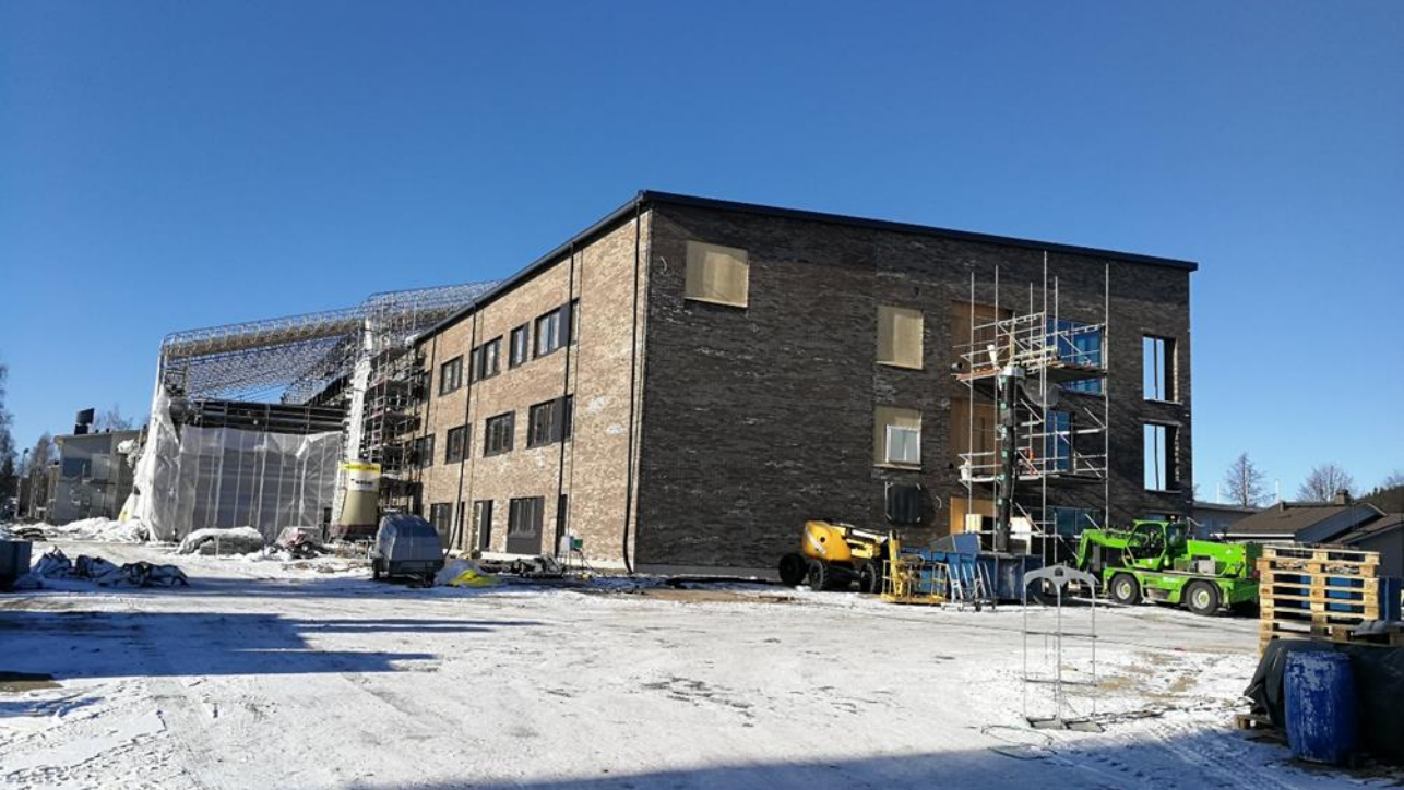
Vesikattotyöt ovat edenneet niin pitkälle, että sääsuojan purku on aloitettu tällä viikolla.
