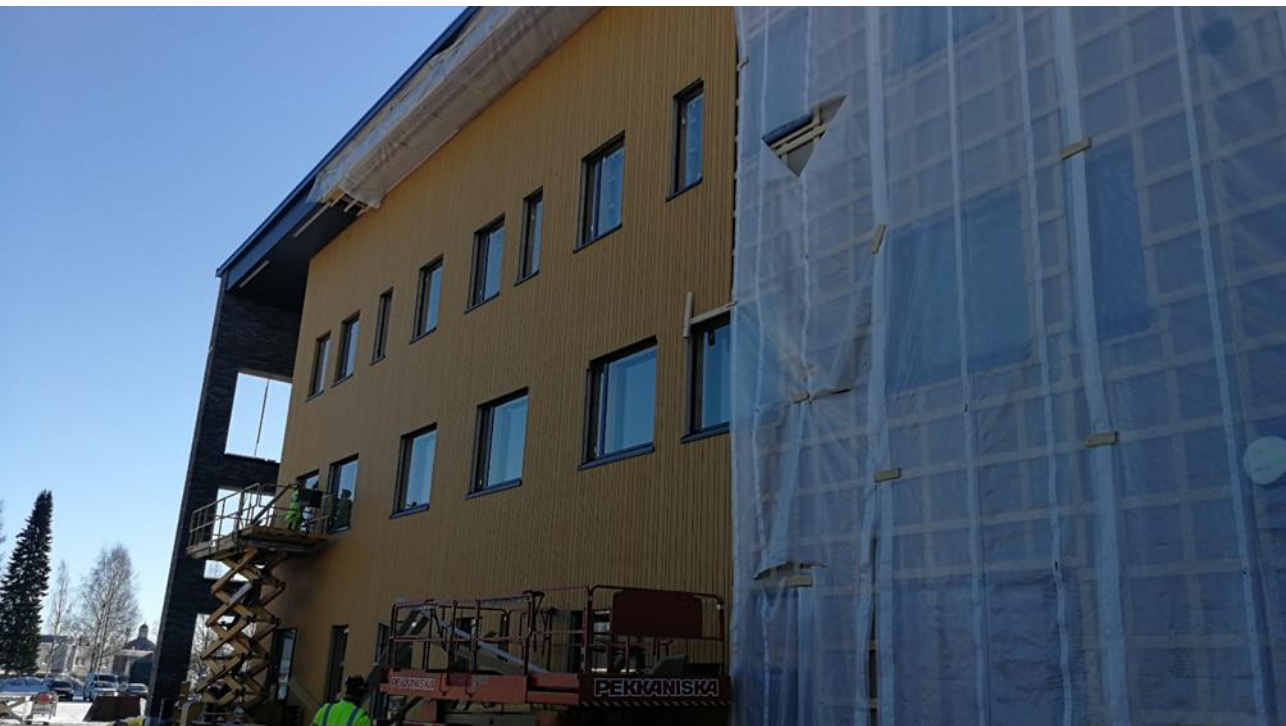
Julkisivupaneelausta on tehty pohjoisen puolella n. ¼ seinästä ja talotekniikka työt ovat hyvässä vauhdissa sisällä.
